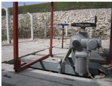
Slika 5. AUMA pogon ugaonog ventila
