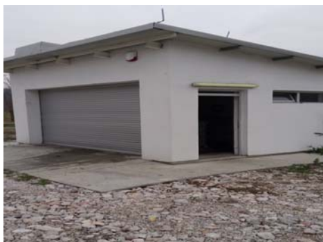
Slika 2. Objekat dozirne stanice
