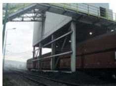
Slika 8. Bočna strana bunkera za utovar uglja sa kojeg je uklonjena akustična reflektirajuća barijera
