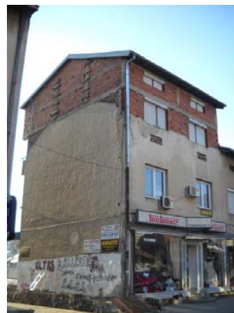
Slika 2. Nadgradnja nad već ruiniranim objektom
