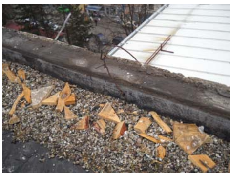
Slika 7. Vezivanje venčanica tankom žicom i armaturom, umesto ankerisanja
