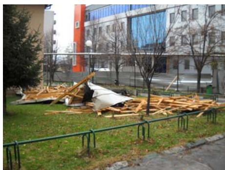
Slika 3. Srušena krovna konstrukcija Tetovske kliničke bolnice
