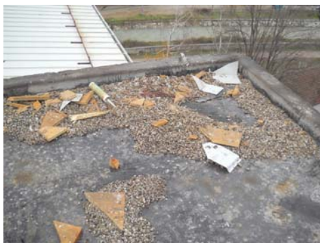
Slika 8. Ostavljeni radni nered u osnovi montiranog krova, otpadci od drveta i pokrivačkih radova
