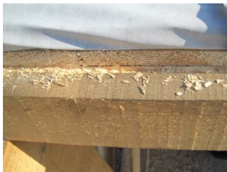
Slika 6. Upotreba motorne testere za prerezivanje dasaka, oslabljivanje i oštećivanje nosećih rogova
