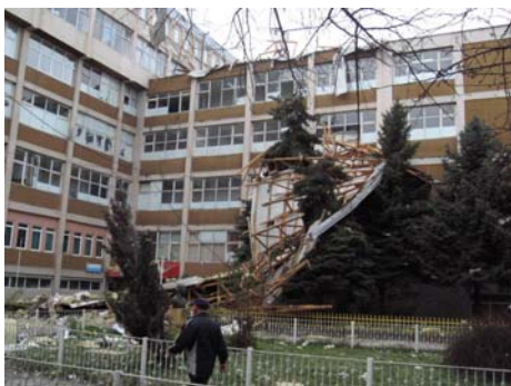
Slika 1. Srušena krovna konstrukcija sa bolnice u Gostivaru
