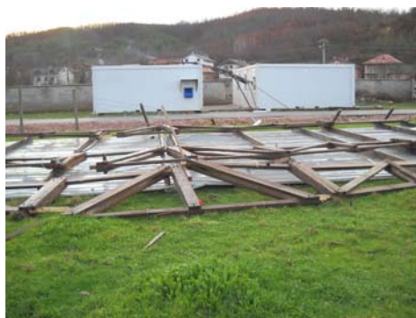
Slika 2. Srušeni krov škole u Trapčin-dolu kod Kičeva
