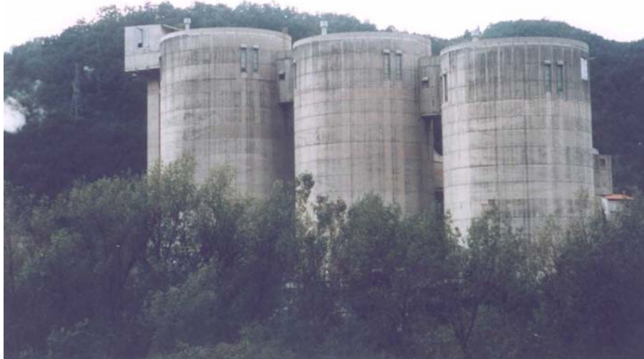
Slika 1: Silosi za skladištenje cementa (pred sanaciju)
